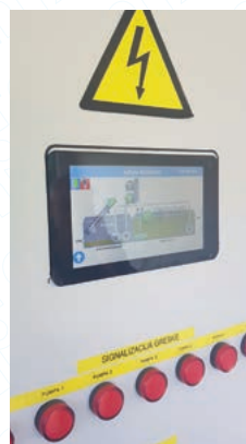
Panel sa svjetlosnom signalizacijom
