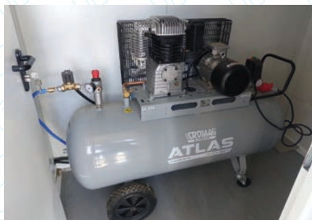
Kompresor tlačne instalacije
