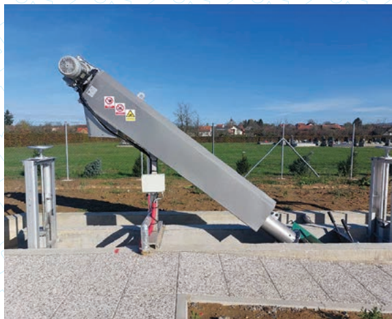
Pužni separator, ispiranje i grijač
