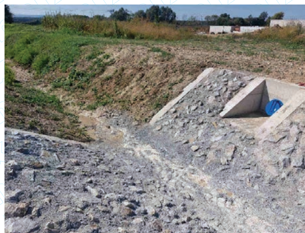
Uređen ispust iz UPOV-a u otvoreni kanal
