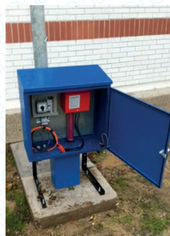
Upravljački elektropanel specijalnog separatora
