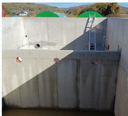
Egalizacijska i prihvata komora s aeracijskim bazenom
